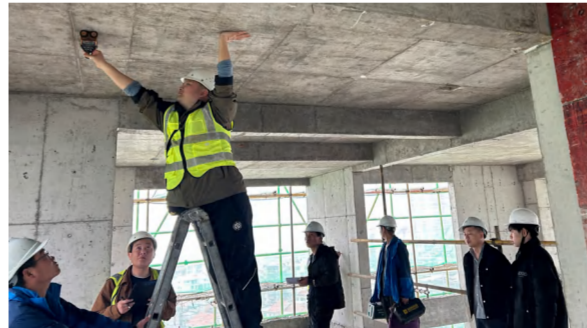
3月23日, 武穴天地项目1#楼、3#楼主体结构工程技术质量五方检测(罗陈摄)
