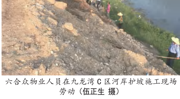
六合众物业人员在九龙湾C区河岸护坡施工现场劳动（伍正生 摄）
